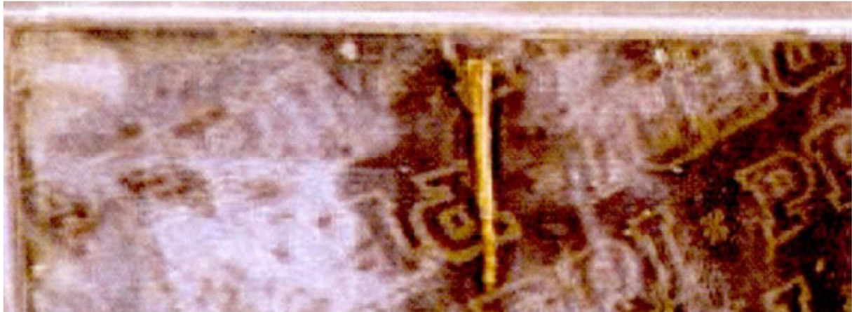
Afbeelding 19: ontoelaatbare krassen in bekistingsplaat (diepte > 1 mm)
