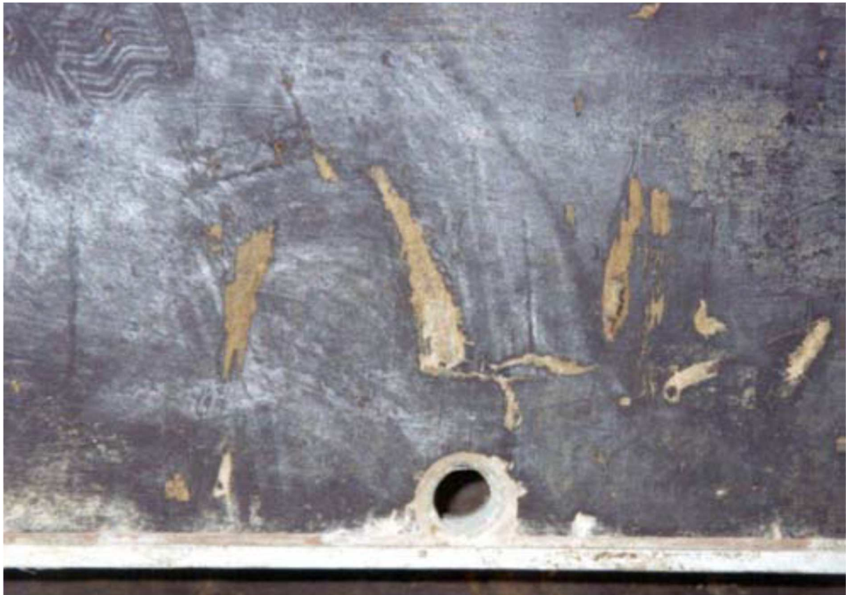
Afbeelding 2: niet toelaatbare beschadiging van de bekistinghuid (diepte groter dan 1 mm door dekfineer gedrukt)
